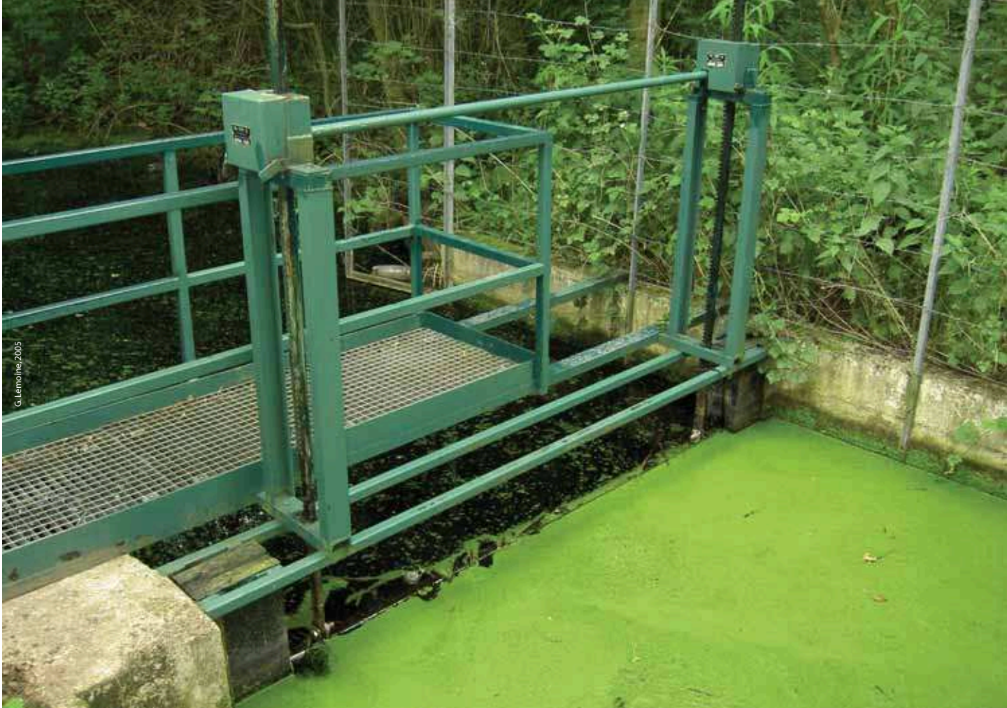
Le système de vanne permet notamment d'éviter l'assèchement estival de la tourbière
